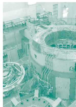
蹴上発電所内部
